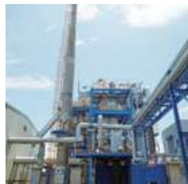
リヴァックスに導入したバイオマスボイラー
