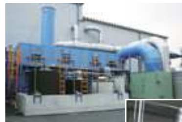
薬液洗浄装置
