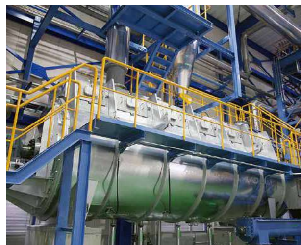
乾燥機施設概要 処理方法：連続油温減圧乾燥方式(油炒め方式) 処理能力：90.9m 3 (約100t)/日(24時間稼働) 処理品目：汚泥、廃油、廃酸、廃アルカリ、動植物性残さ 環境対策：バイオマスボイラー、薬液洗浄装置
