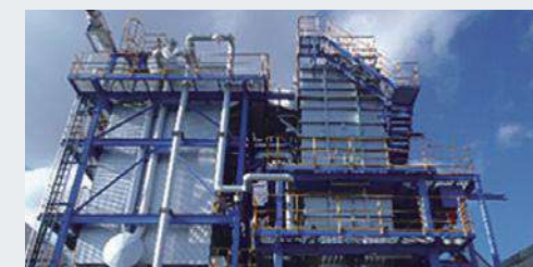
バイオマスボイラー
